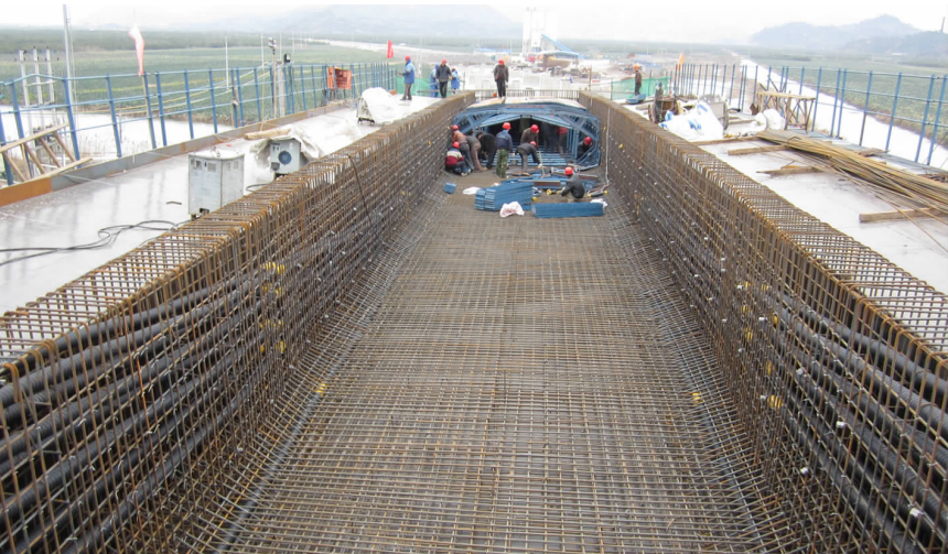
日前，74省道南延三门段第二合同段浦坝港大桥标志性工艺——桥梁上部现浇箱梁（移动模架法施工）第一孔顺利完成浇筑作业。该工程共用时16小时。这标志着浦坝港大桥全面进入上部攻坚阶段。
